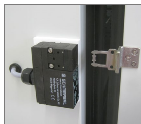
Elektromechanische Türverriegelung gesteuert über Zeitprogramm oder manuellen Betrieb
