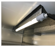
Beleuchtung mit Bewegungsmelder
