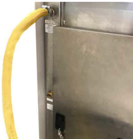
Figure 31: Tuyau d'eau connecté à l'arrivée d'eau douce
