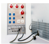
Conexión directa con línea presurizada de agua ultrapura
