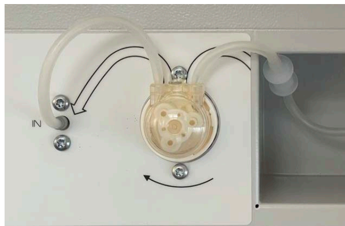
Figure 23: Alimentation en eau par sac d'eau douce, montée
