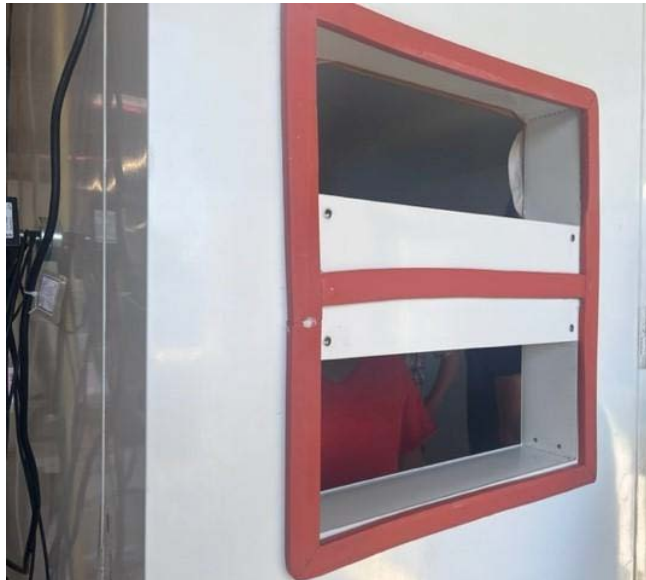
Figure 24 : Arrière de la chambre avec joint en silicone à la position du climatiseur
