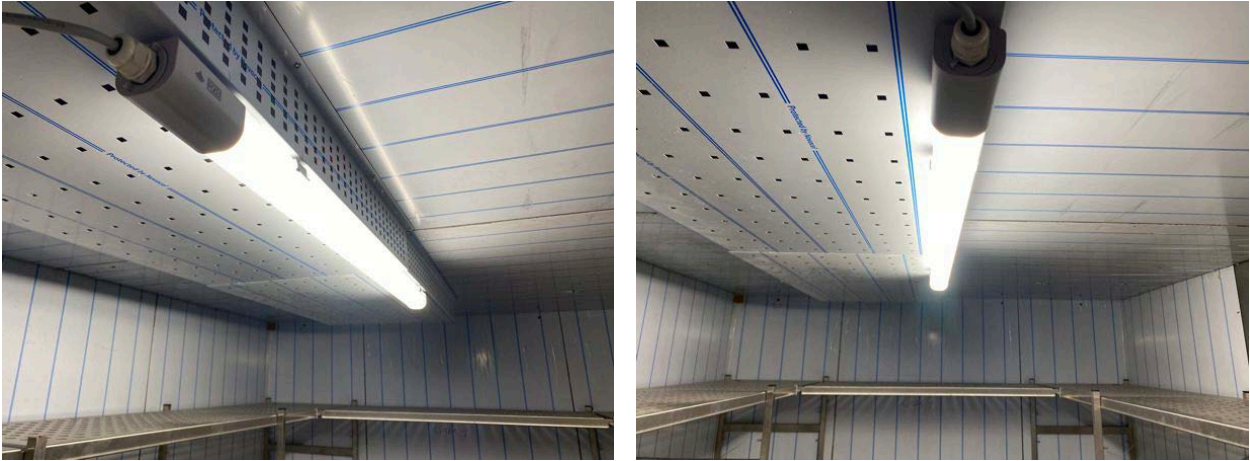
Figure 49 : Vue de l'éclairage installé
