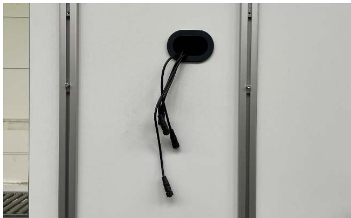
Abbildung 16: Kabel von den Verteilern der LED-Lichtleistenkabel, durch die Langlochdurchführung nach außen geführt
