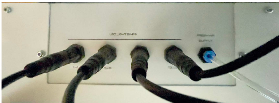
Abbildung 18: Anschlüsse an der Oberseite der Pflanzenlichtbox, montiert
